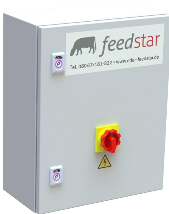
Abb. 18 Schaltkasten mit Haupttrennschalter
