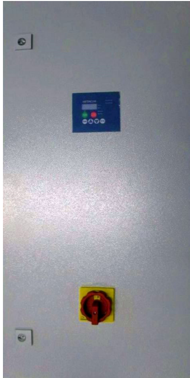
Abb. 6 Schaltschrank mit Haupttrennschalter
