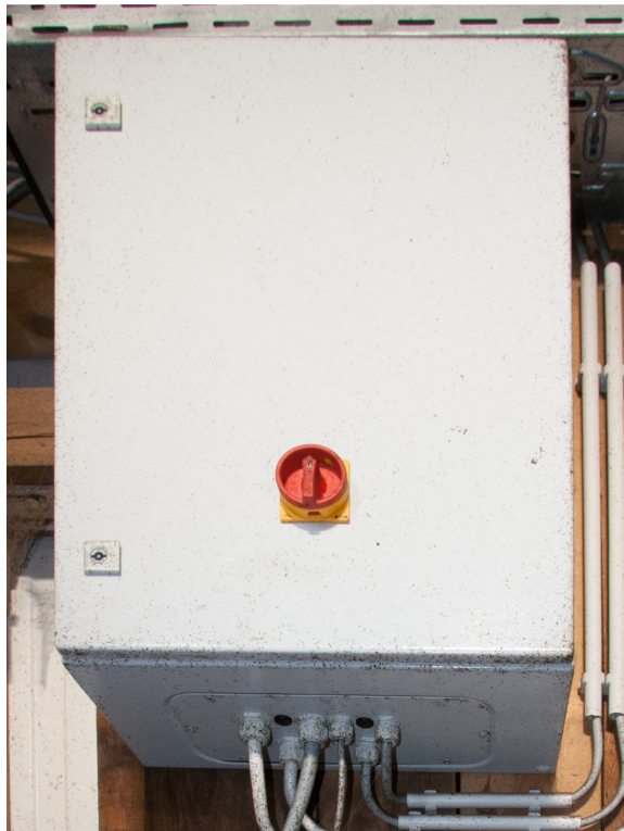
Abb. 3 Schaltschrank mit Haupttrennschalter
